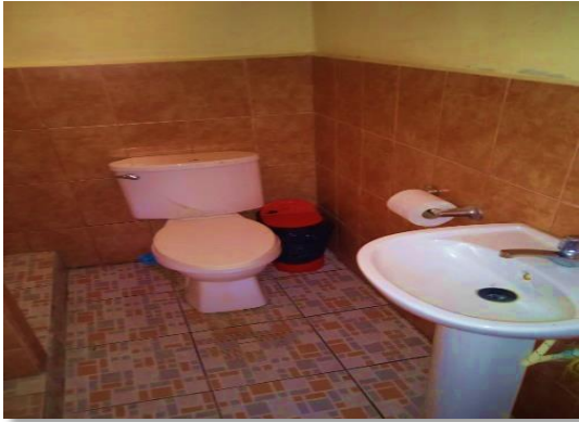
Figura 23. Instalaciones Sanitarias Fuente: propia
