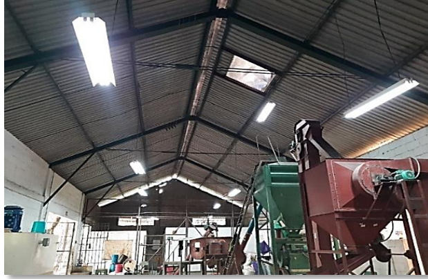
Figura 17. Iluminación del área de producción Fuente: propia
