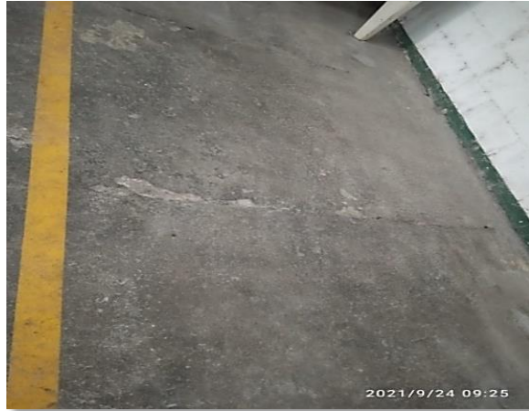
Figura 10. Piso del área de producción Fuente: propia
