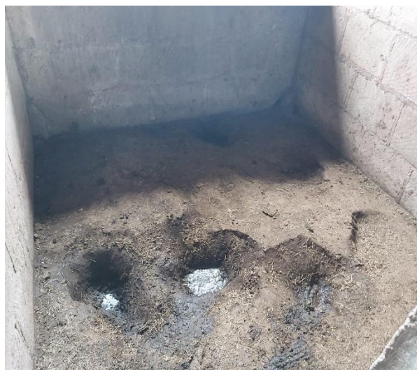
Figura 6. Daños en el piso de los boxes.
