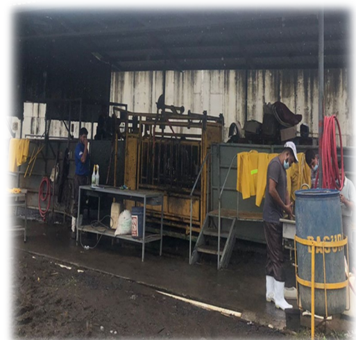
Figura 17. Trampa hidráulica del área de sanidad animal
